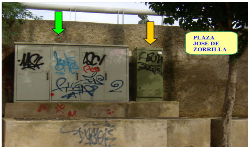
Equipo de medida. Cuadro Alumbrado Público Nº 54
