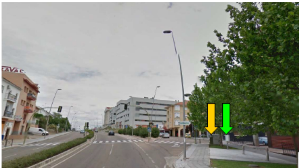
Regulador y Equipo de medida. Cuadro Alumbrado Público Nº 63
