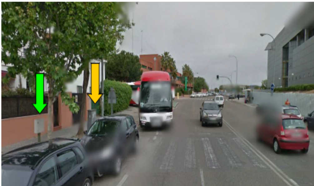
Regulador y Equipo de medida. Nº Contador: 23742
